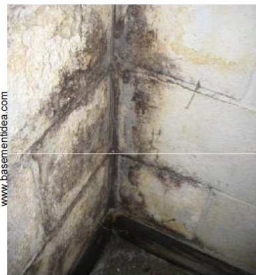
Schimmelbelag der Wand im Keller
