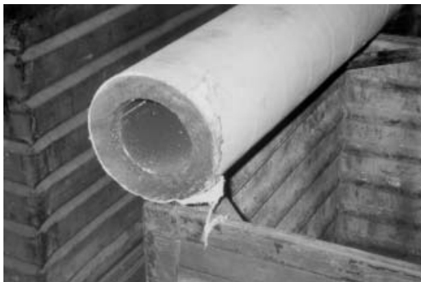
Asbesthaltige Rohrisolation, Foto IST
