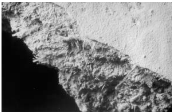
Zerbrochene Asbestzementplatte mit sichtbaren Asbestfaserbüscheln, Foto: SA
