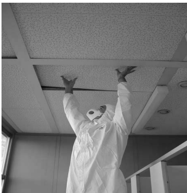
Asbesthaltige, abgehängte Deckenplatte (Akustikplatte), Foto IST
